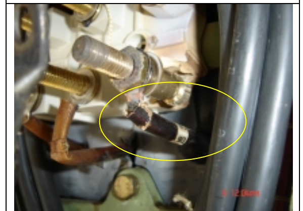
Fig 2 Deterioro Aislante Línea hacia el Motor
