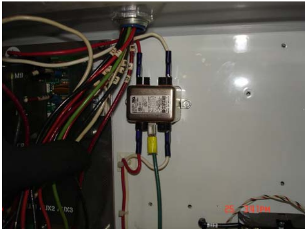
Figure13 – Filtros de línea instalados en el nuevo controlador.
