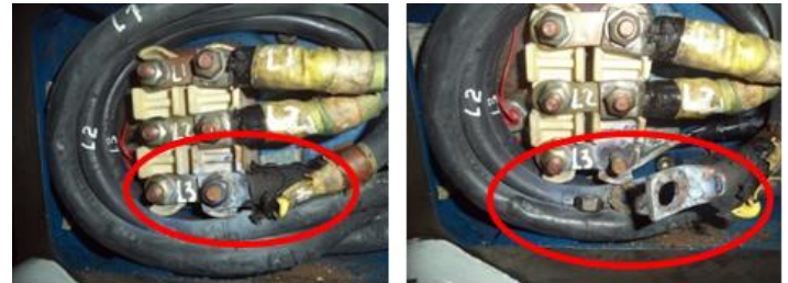
Fig.3. Fotos de hallazgos, recalentamiento L3 de alimentación
