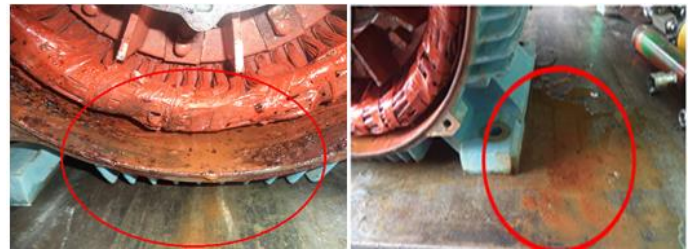
Fig.2. Fotos de hallazgos, contaminación con agua
